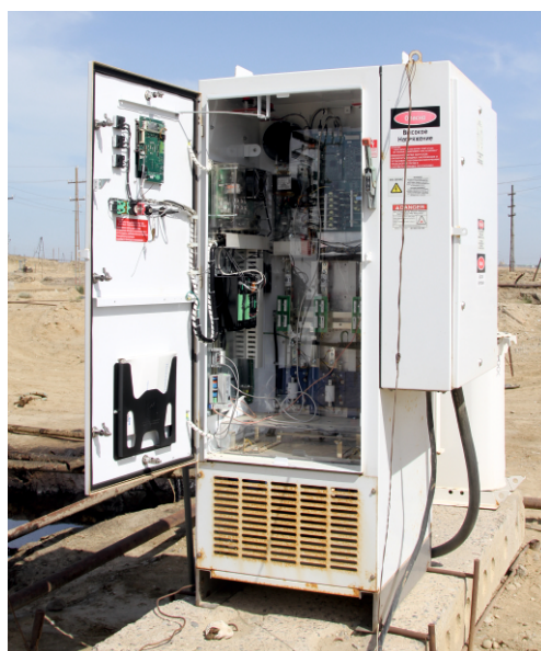
Станция управления оборудованием нефтедобывающей скважины. Месторождение Бинагади, Азербайджан.
